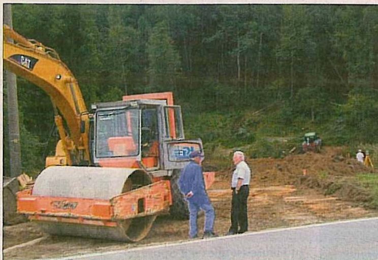
2. Bürgermeister Josef Eisenschink (rechts) besichtigte zum Start der Arbeiten die Baustelle. (Foto: Fuchs)
